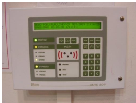
Centrální požární signalizace
